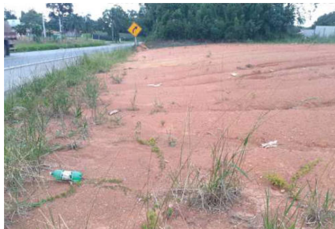
Erosão em sulcos nas proximidades da rodovia.
