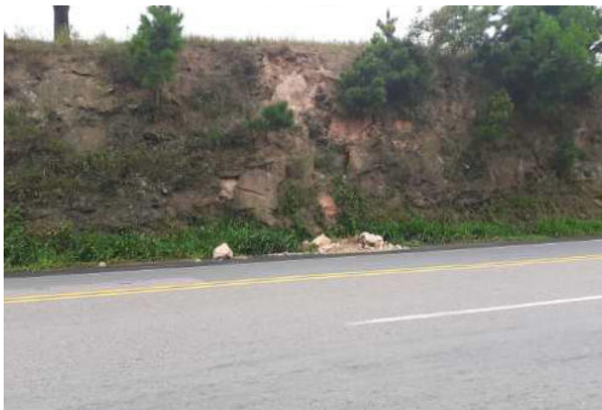
Rochas soltas em terreno inclinado em trecho da rodovia
