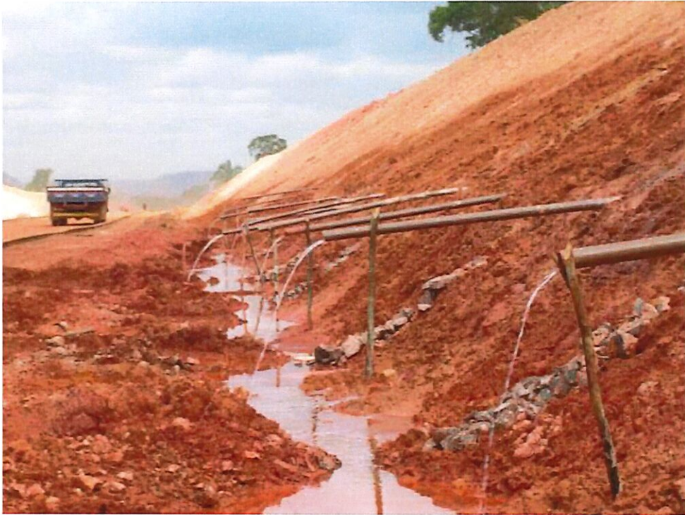
Fig. 46. Detalhe dos DHPs em pleno funcionamento
