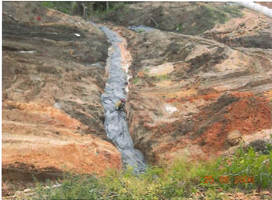
Fig. 48. Execução de dreno subterrâneo (charuto), com objetivo de proteção de nascente e manutenção do corpo hídrico.
