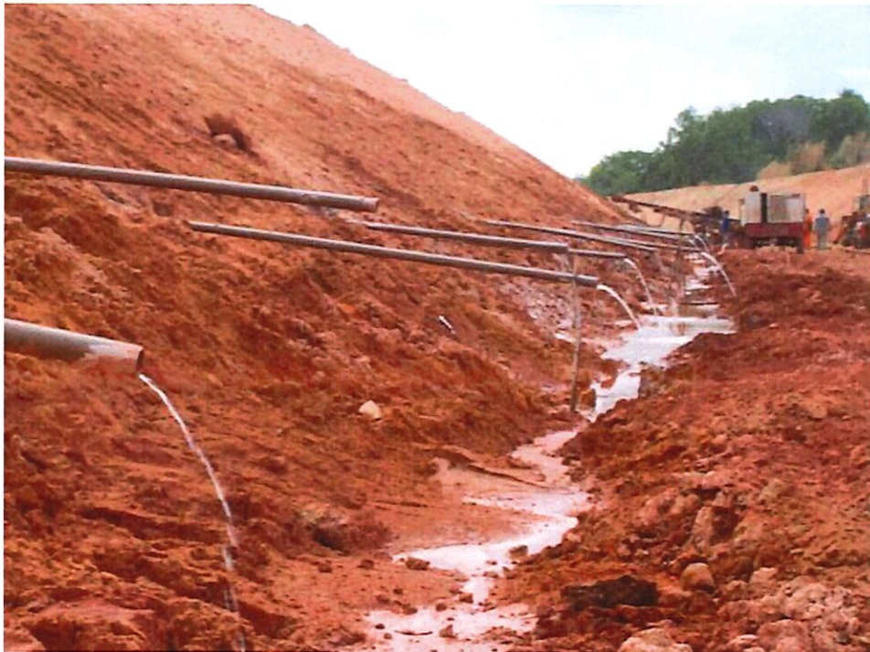
Fig. 47. Vista dos drens em funcionamento e do equipamento de perfuração
