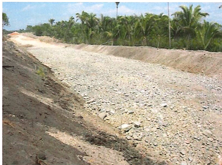
Fig. 43. Execução de colchão drenante em corte com presença de água no subleito
