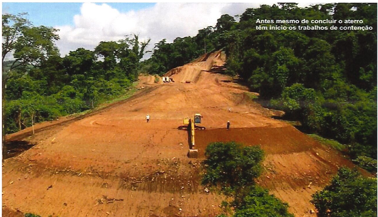
Figura 20. Fase 3 – Escarificação do talude de aterro para melhor fixação da proteção vegetal
