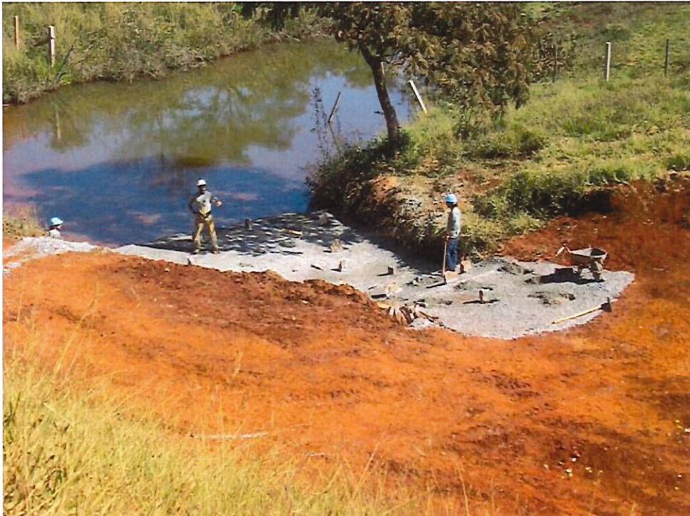
Figura 29. Aspecto geral – Construção de bacia de dissipador de energia logo abaixo da bacia de contenção.
