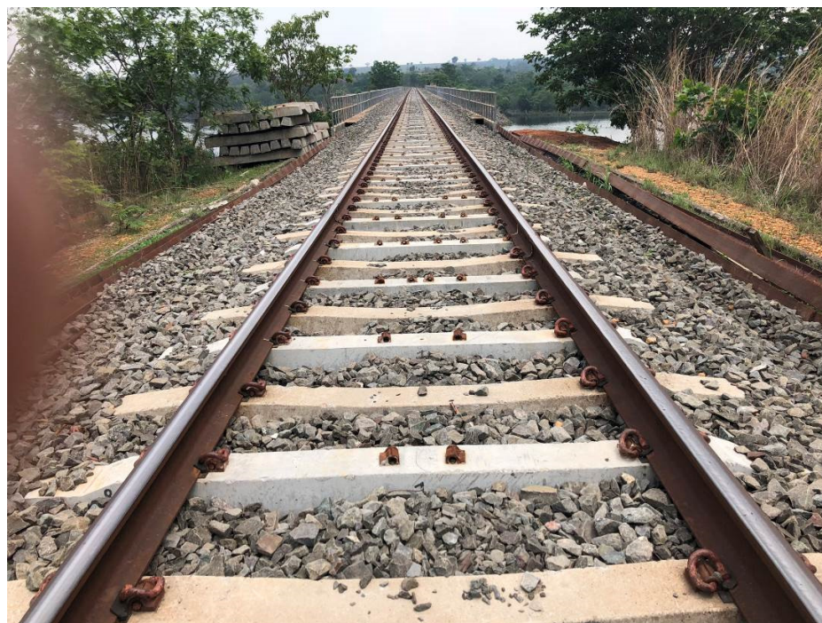
24 – Figura A.8.1.3.4 Substituição de dormentes de concreto em ponte, com preparação para
