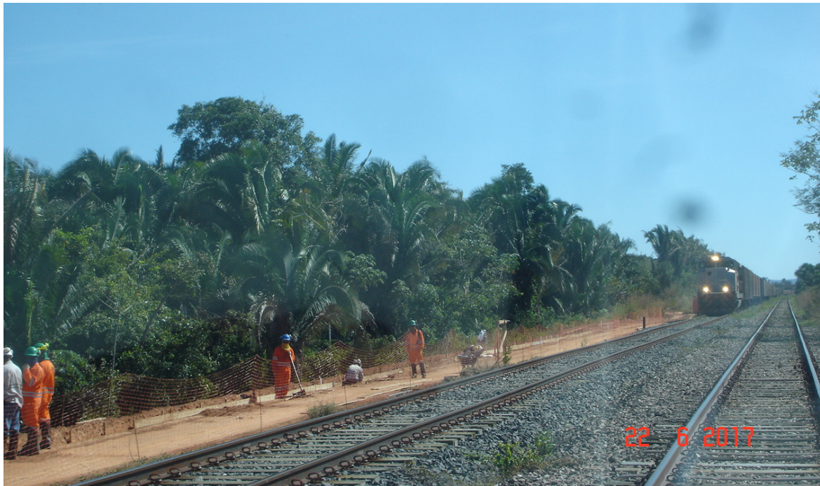
22 – Figura A.8.1.3.2 Obra de correção de talude e caminho de serviço no Pátio de João Lisboa.
