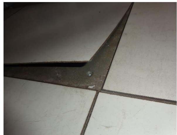
Figura 29: Lajota parcialmente descolada do assoalho.
