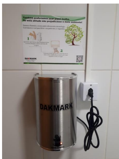
Figura 2: Secador de mãos instalado no banheiro e pôster de divulgação sobre o seu uso correto.
