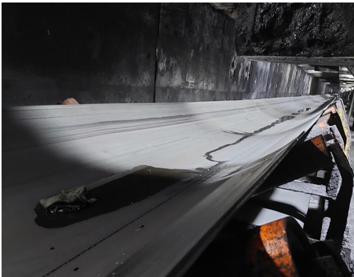
Figura 33: Correia Transportadora da CBR (trecho subterrâneo - abaixo do nível do cais). Fonte Imagem obtida durante visita técnica da INFRA S.A. (2022).
