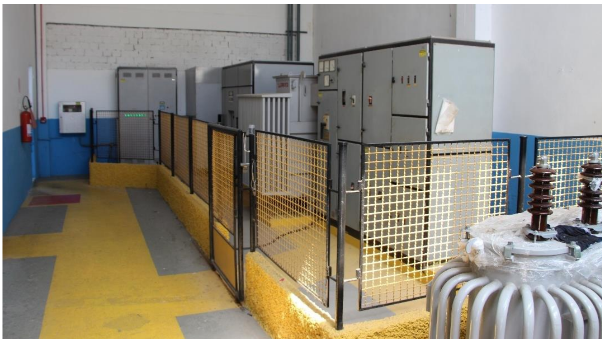
Figura 136: Quadro de distribuição de energia da fábrica de gelo do Porto de Laguna Fonte: Imagem obtida durante visita técnica da INFRA S.A. (2022).
